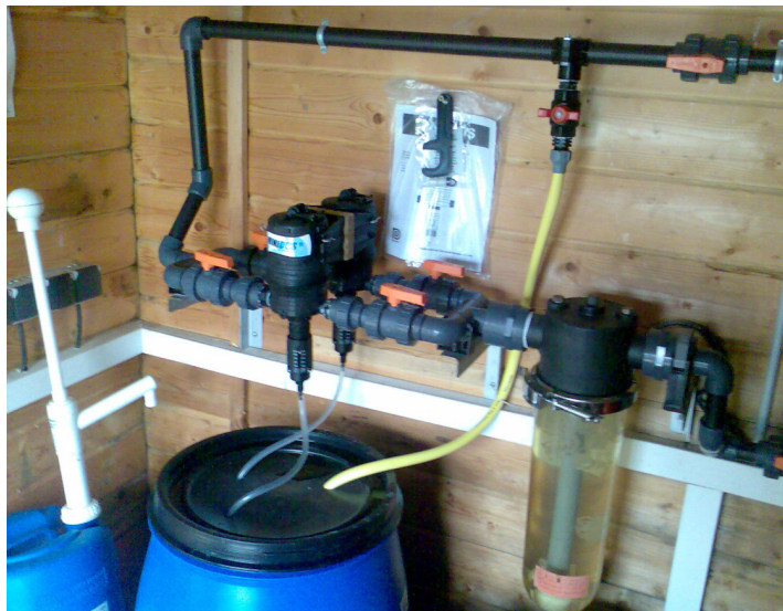
Impianto di miscelazione fertilizzanti
