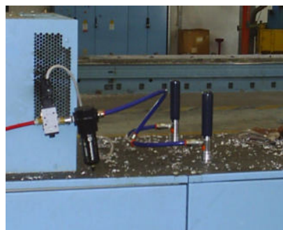
Condizionatori Exair 4030 su quadro elettrico di un'alesatrice
