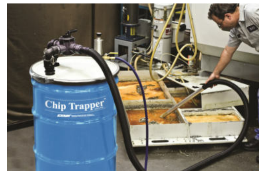
Trucioli ed emulsione nella vasca della macchina
