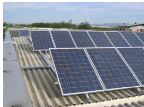
l'impianto fotovoltaico da 13 kW
