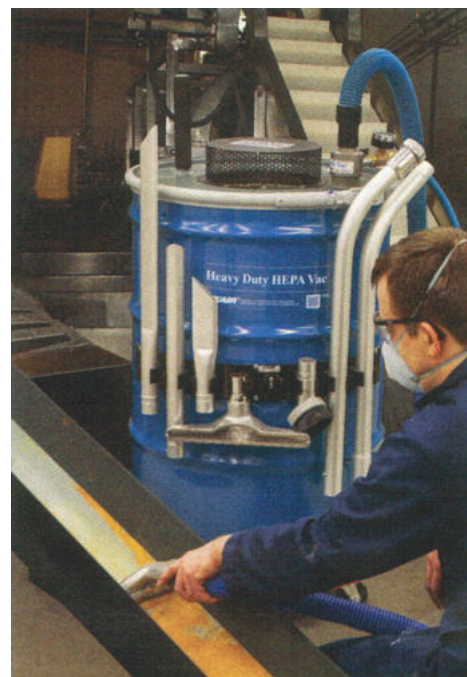
Pulizia di una canalina dalla polvere prodotta dall'impianto
