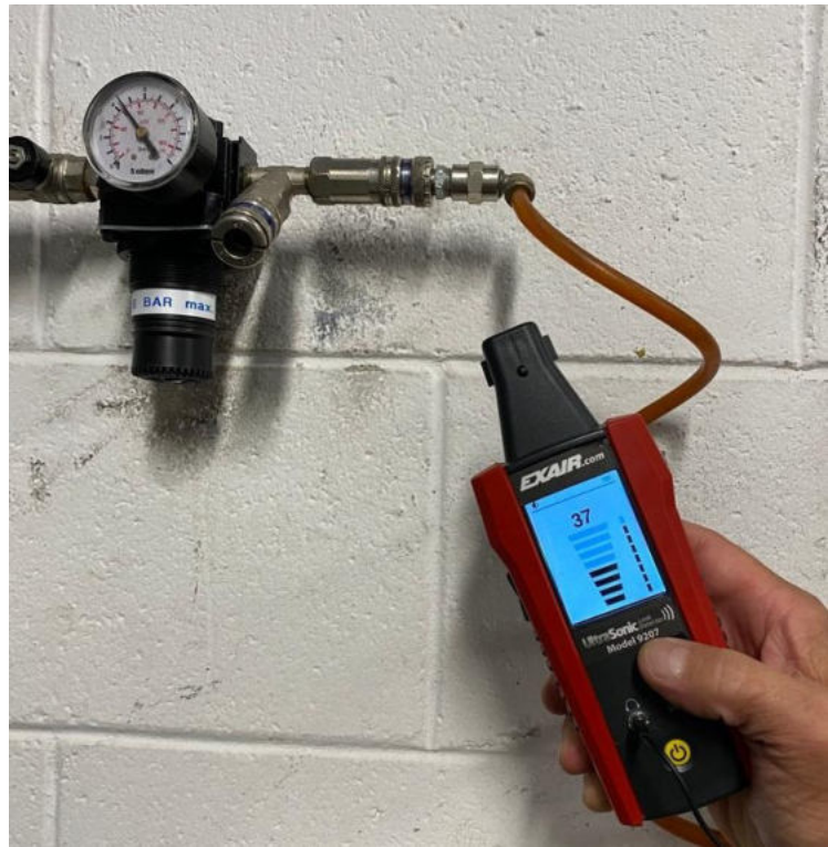
Verifica perdite da raccordi pneumatici
